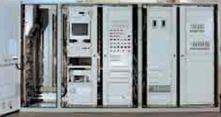
7 Komplett Ansicht der Einheitenleittechnik
